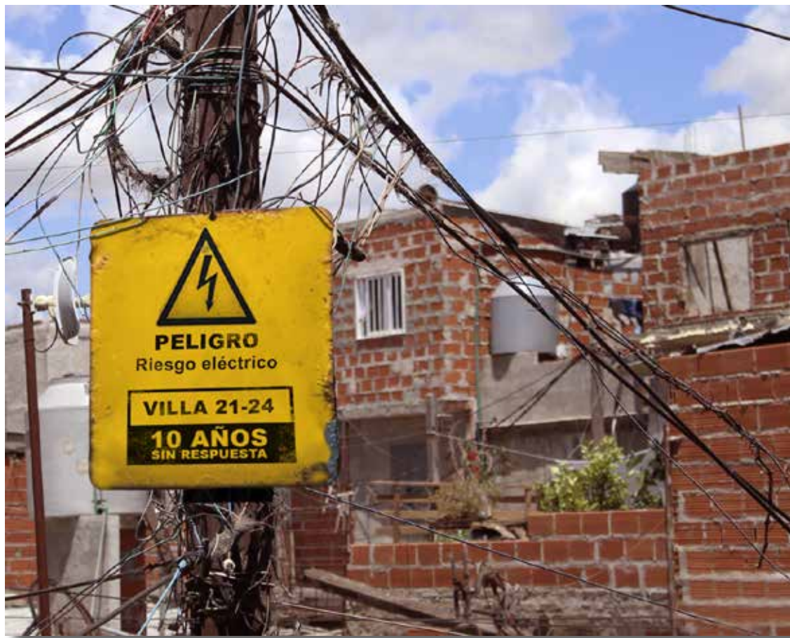
En la red pública, solo el 3% de las ménsulas está en buen estado, mientras que el 64% está dañado, es improvisado o directamente no existe.
